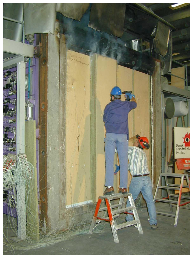
Figur 5 Afdækning af pladefelt grundet gennembrænding.
